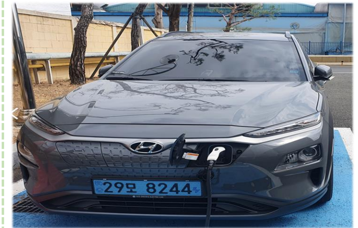
[사업장 내 전기차 충전소 설치]
